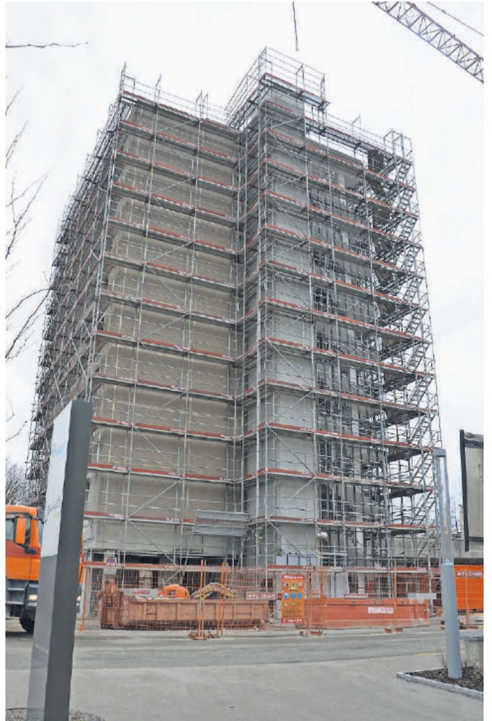
Die 54 Alterswohnungen, die bis im Mai 2018 im Hochhaus K realisiert werden, sind für die Bewohner der benachbarten Alterswohnungen, die später abgerissen werden, reserviert. (JAM)
